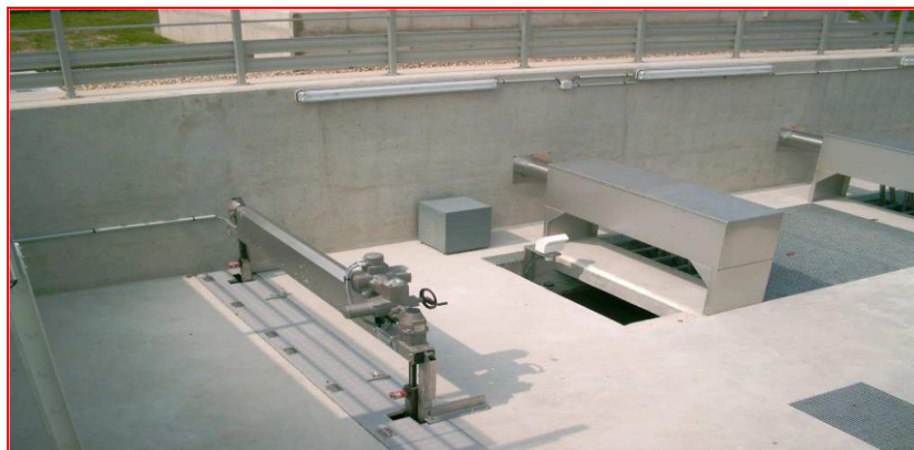
Figure V.6. Installation de désinfection par ultraviolets
