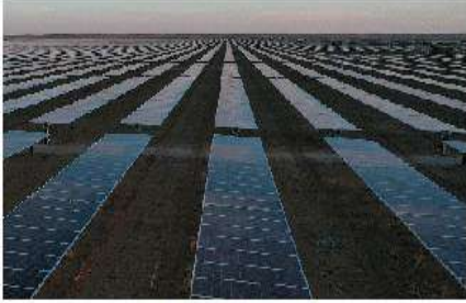
مشروع محطة رابغ للطاقة الشمسية
